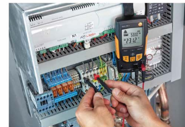
测量热泵开关盒中的电压
