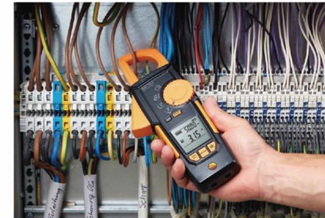
测量开关柜电流
