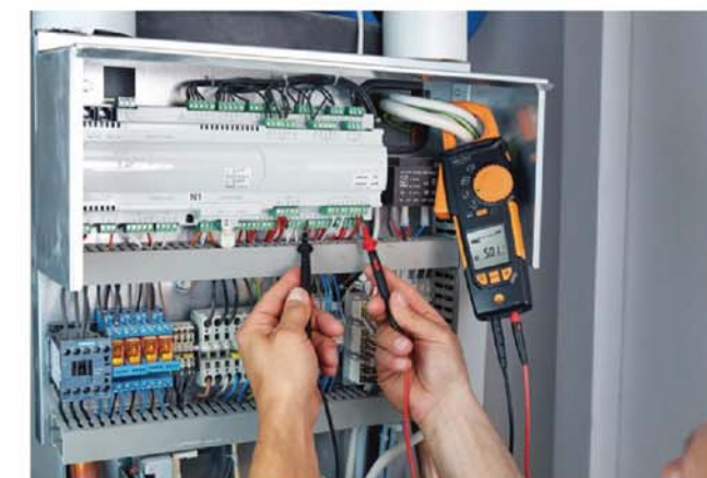
测量开关柜电压
