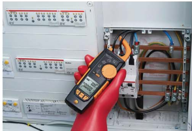
测量开关柜电流
