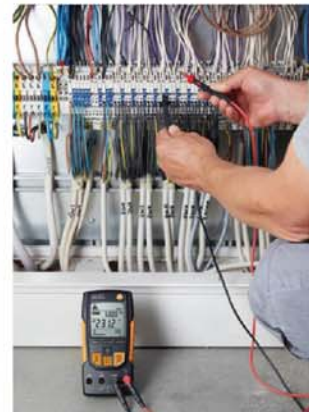
测量开关柜中的电压
