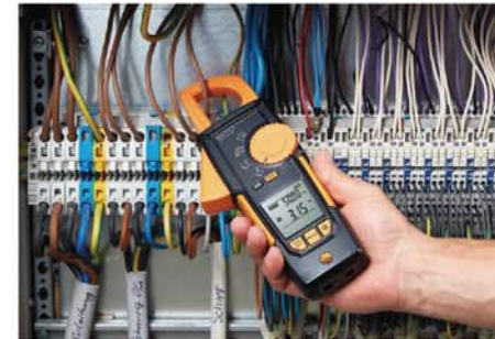
测量开关柜电流
