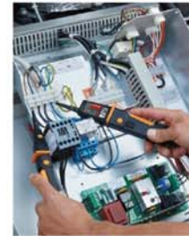
测量压缩机电压
