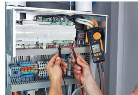
测量开关柜电压
