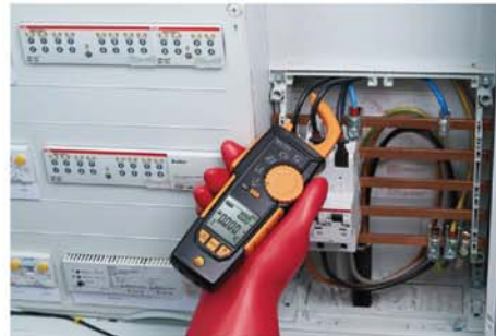
测量开关柜电流
