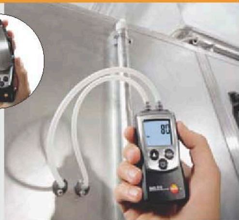
测量过滤器的差压
