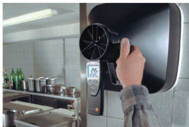
testo 417，检测墙面通风设备的排风量
