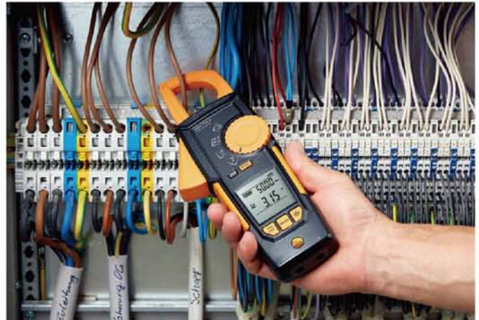
测量开关柜电流
