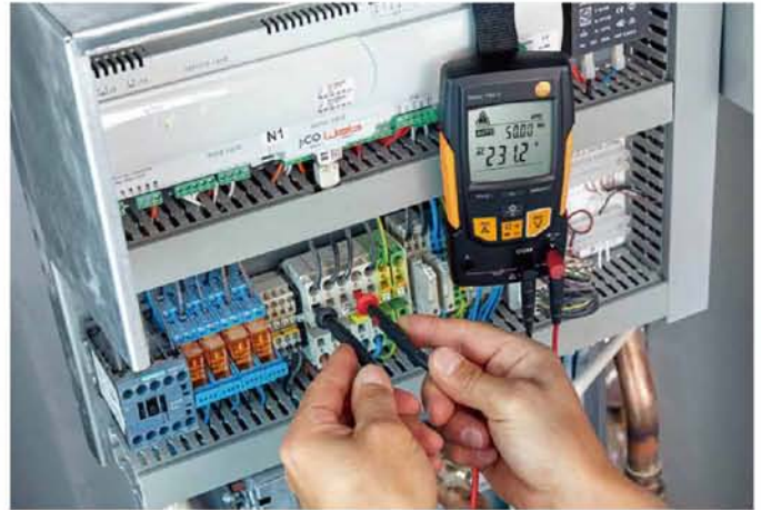
测量热泵开关盒中的电压
